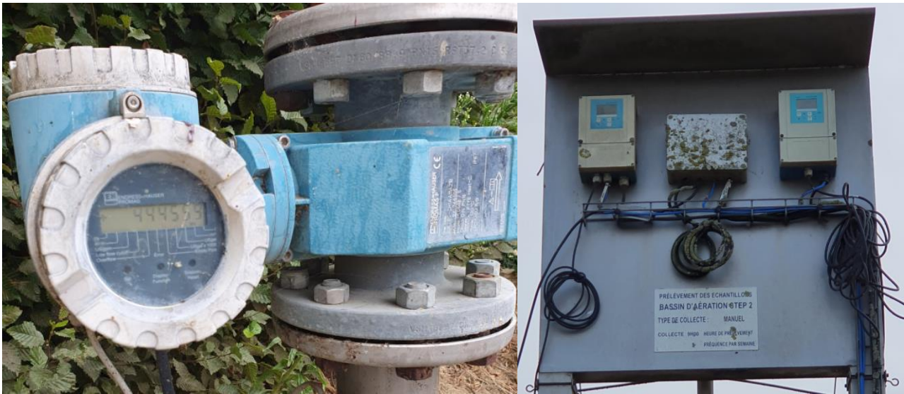
PHOTO 3 : POINT DE PRELEVEMENT ECHANTILLON DU BASSIN D'AERATION ET COMPTAGE DU DEBIT DU POINT PR3 AVANT TRANSFERT VERS LE RESEAU EU DE LA COMMUNE DE LUNERAY
