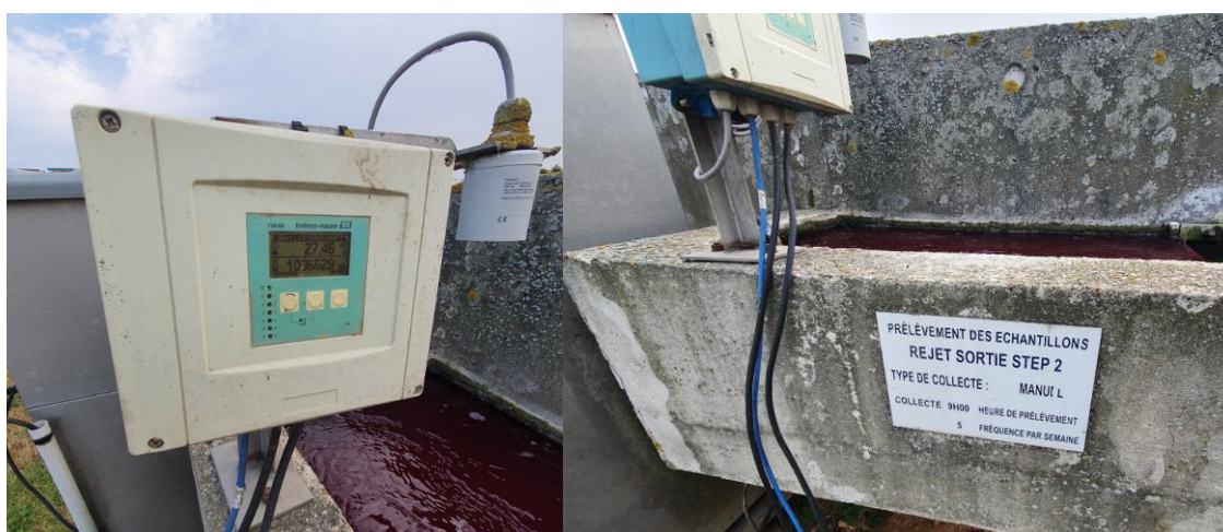
PHOTO 2 : POINT DE PRELEVEMENT ECHANTILLON ET COMPTAGE DU DEBIT DU POINT PR2 EN SORTIE DE LA STEP AVANT TRANSFERT VERS LES LAGUNES DE BRACHY
